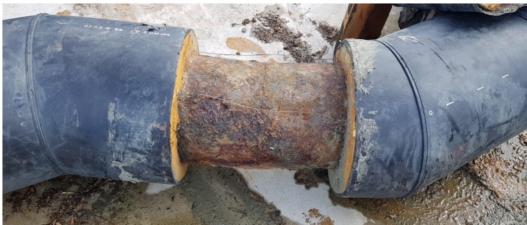
Tæring af fjernvarmerør som følge af forkert udført muffearbejde
